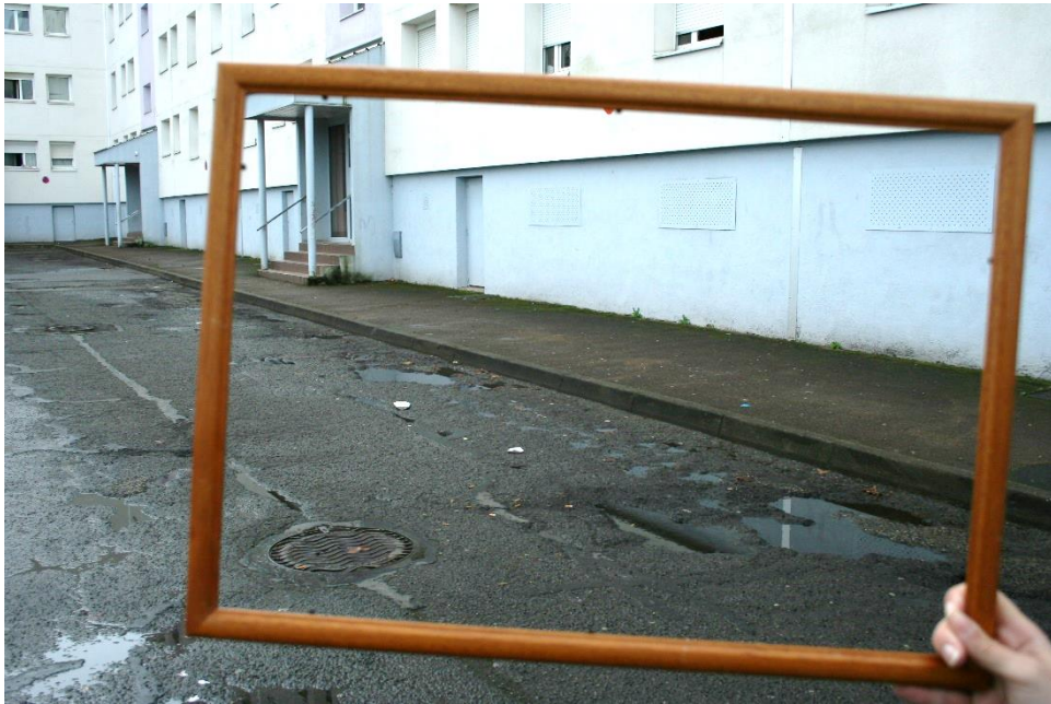
Image 7 - Photographie de la voirie abîmée prise le 31/01/21
